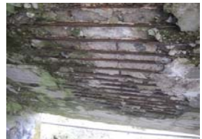
鉄筋露出のRC床版橋
